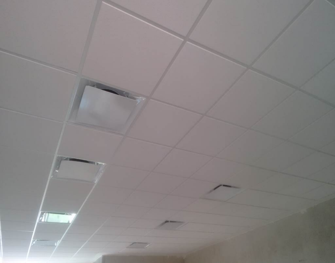
SUMINISTRO Y COLOCACION DE FALSO PLAFON Y LUMINARIAS EN LA TERMINACIÓN DE LA CONSTRUCCIÓN DEL EDIFICIO DE INGENIERÍA PETROLERA.
