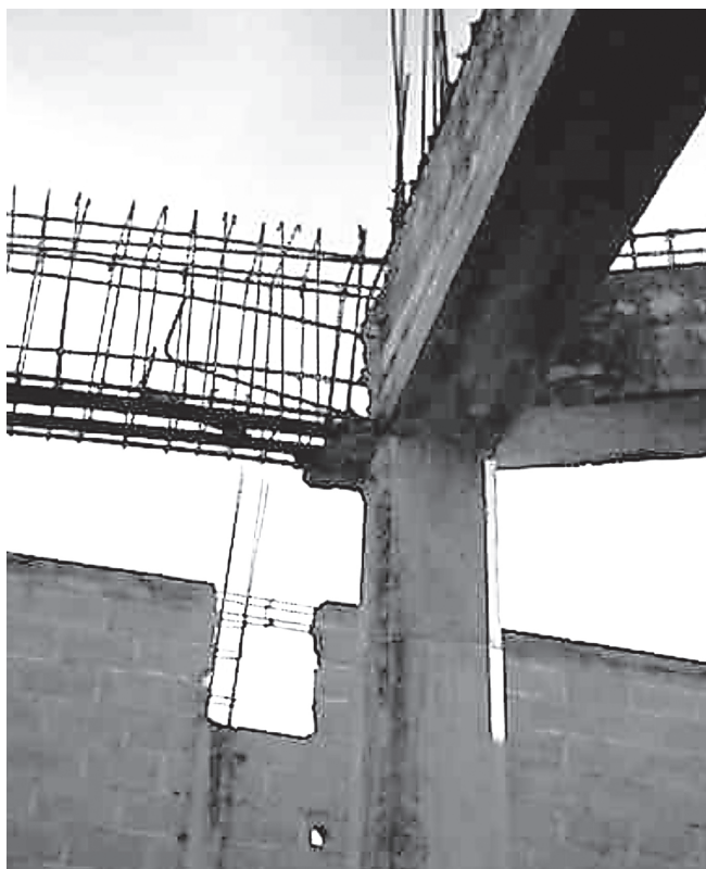
Figura 9. Corte de colado mal ubicado
